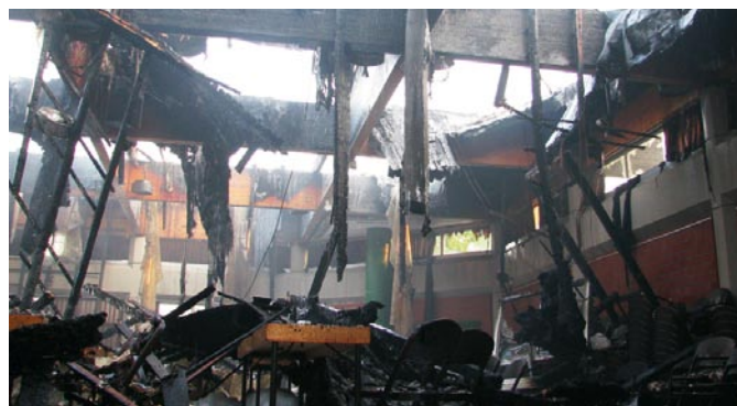
Die zerstörte Aula
